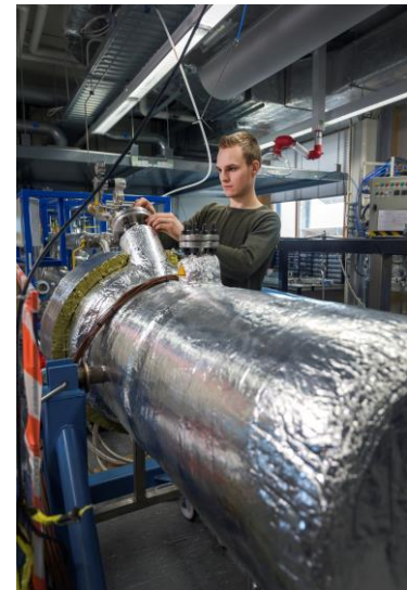
10 kW PCM warmteopslag systeem 130°C
