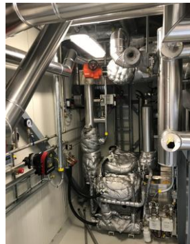
200 kW compressie Warmtepomp test systeem voor 150°C stoom levering
