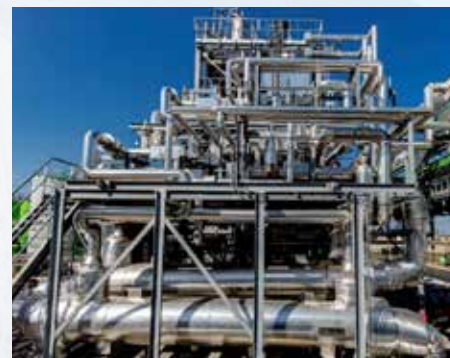
Installatie voor het omzetten van plastic afval in hoogwaardige pyrolyse olie (bron Blue Alp)
